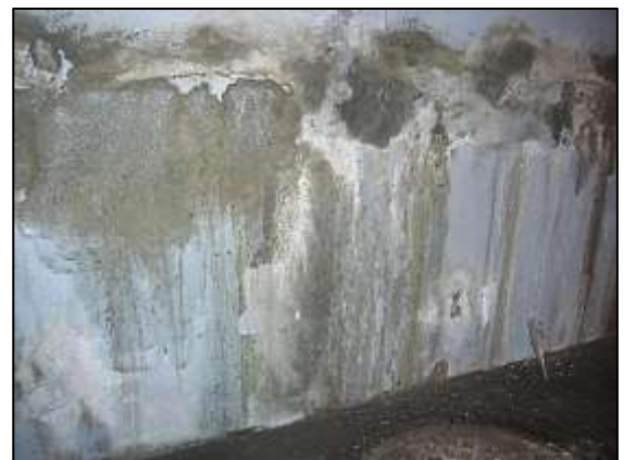
Рисунок 3.11 – Формирование высолов на бетонах (секции №5)
