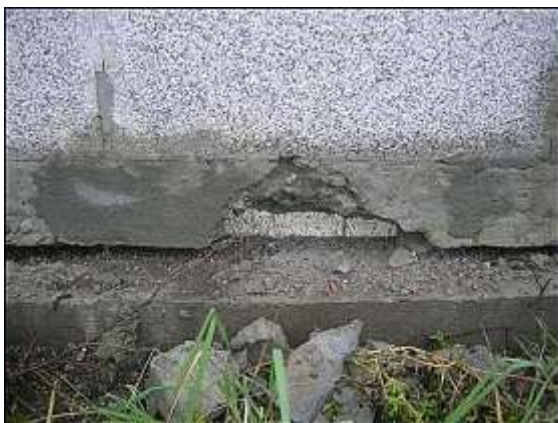
Рисунок 3.10 – Повреждение бетона (секция №7/8)
