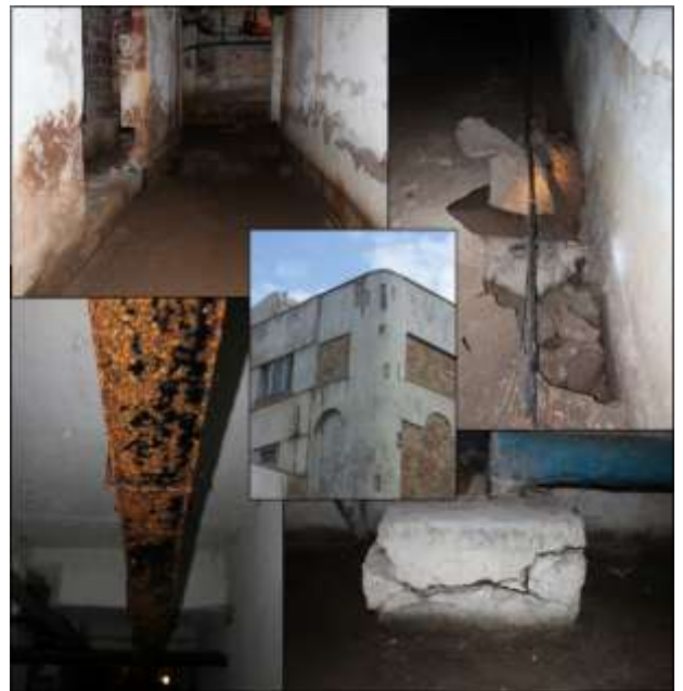
Рисунок 3.39 - Дефекты наземной и подземной части здания больницы
