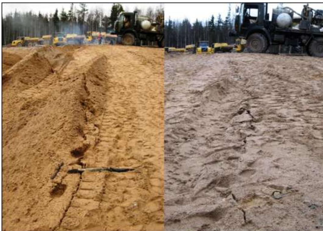
Рисунок 3.25 – Образование трещин в приоткосной части насыпи
