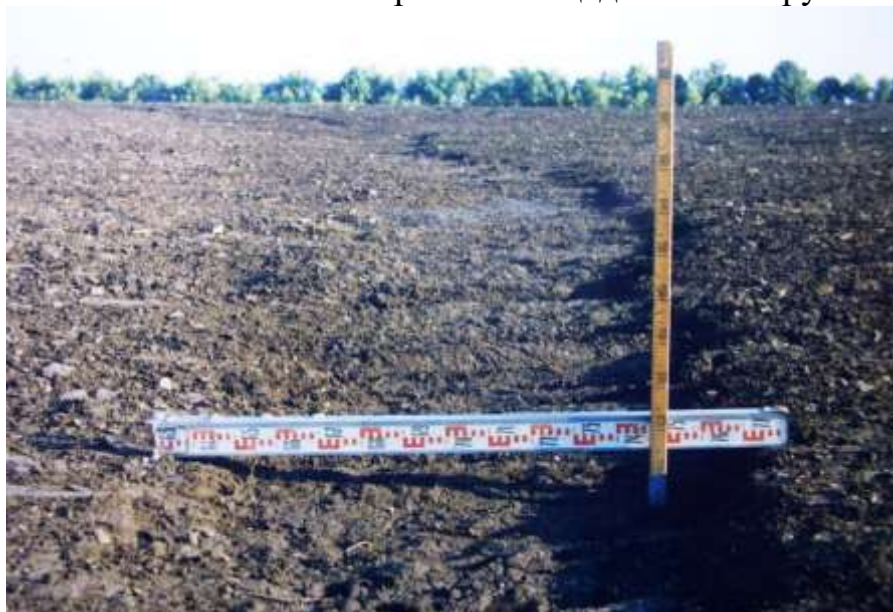
Рис. 2.2. Детальное измерение глубины промоины в ложбине по ее ширине
