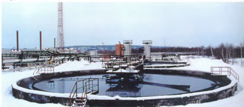
Очистные биологические сооружения.
