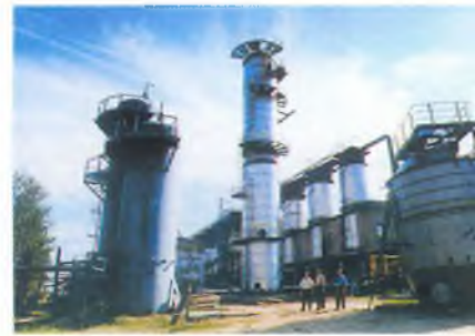
Новый реактор колонного типа по производству битума на фоне старой установки. 1999 г.
