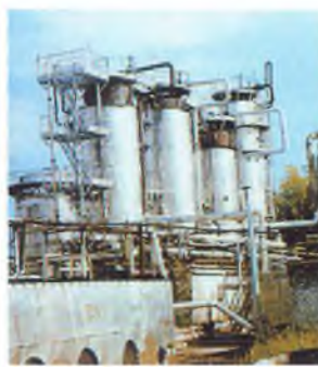
Установки Ухтинского НПЗ.
