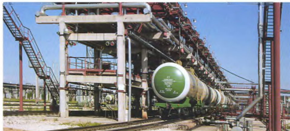
Эстакада налива светлых нефтепродуктов. Открытие комплекса новых объектов состоялось в декабре 2000 года.
