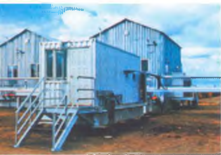
Модули, в которых установлены газовые компрессоры по закачке в нефтяной пласт попутного нефтяного газа. Южный Кыр- таель. 1999 г.
