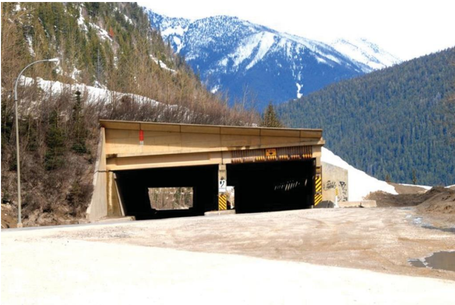
Рис. 8.41. Лавина и защитное сооружение на перевале Роджерс, Канада. © S. A. Harris
