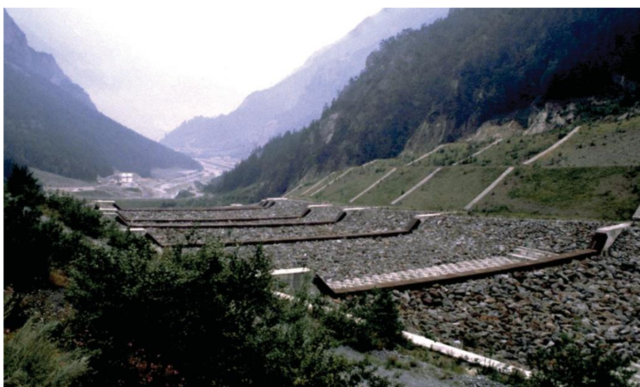
Рис. 8.27. Фильтрующие плотины в качестве защиты от обломочных потоков (селей), Бор-мио, Италия. © S. A. Harris
