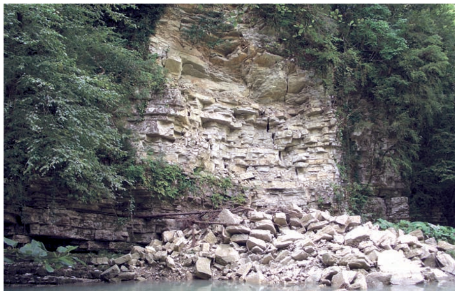
Рис. 3.45. Обрушение выветрелых слоистых горных пород (физическое выветривание) (правый берег р. Хоста, Хостинский район Большого Сочи)
