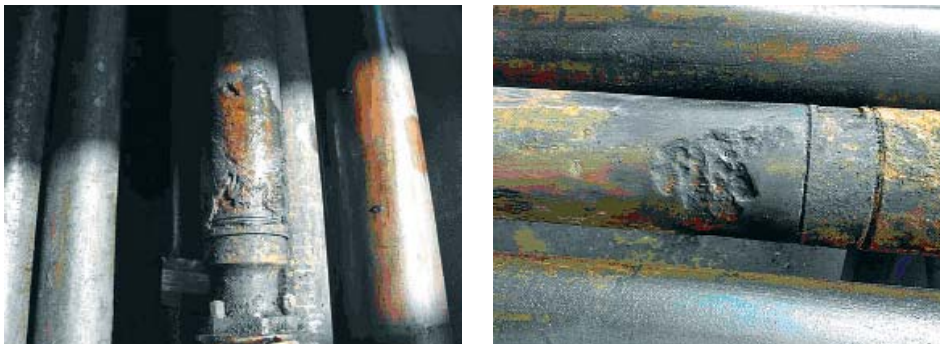
Рис. 13. Коррозия элементов насосного оборудования
