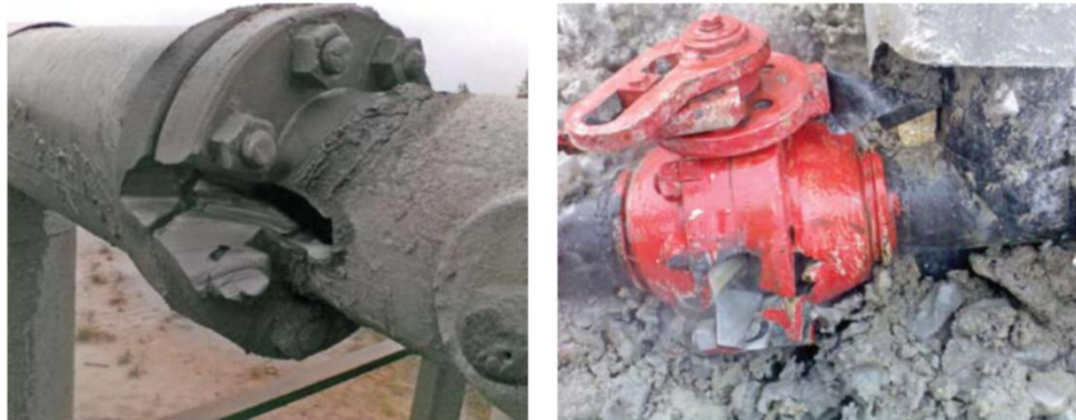
Рисунок 4.43 – Разрушение трубопроводов вследствие высокой скорости течения
