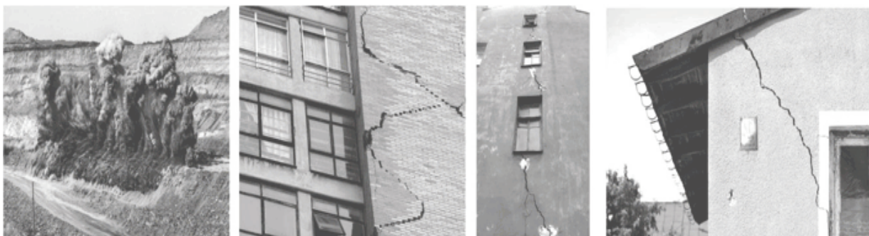
Рис. 1 – Разрушение зданий , вызванное сейсмическими воздействиями буровзрывных работ
