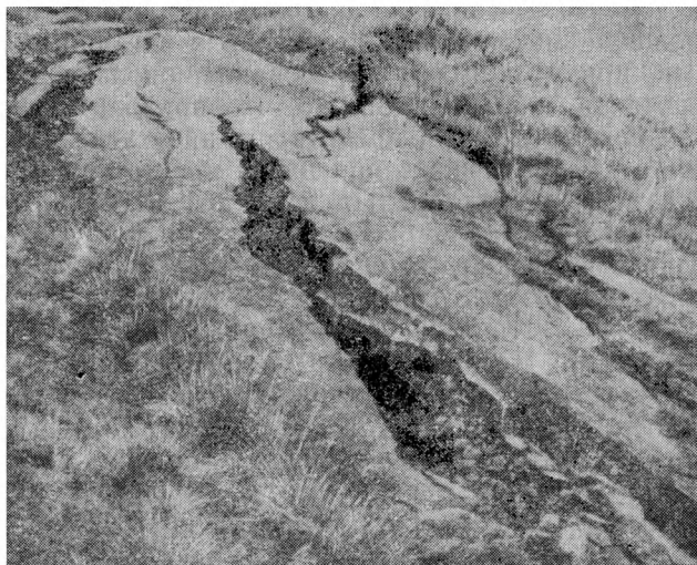
Рис. 6.1. Повреждение дороги в результате просадки грунта (фото Барнеби).
