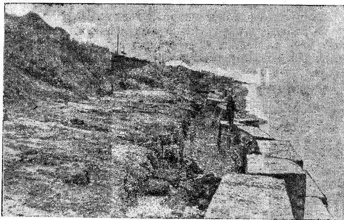
Рис. II-32. Волноотбойная стенка из отдельных бетонных блоков, разрушающаяся под влиянием подмыва.
