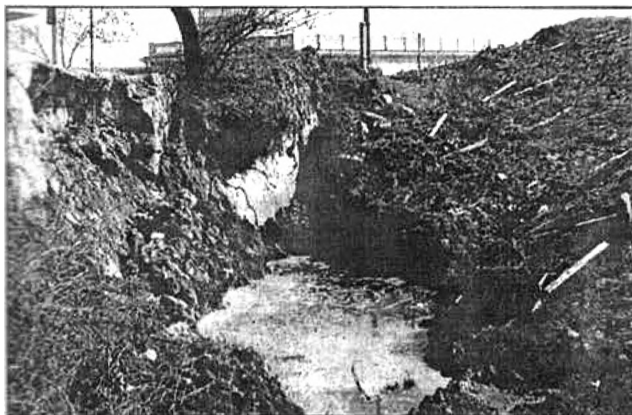
Рис. 4. Катастрофическая подвижка на оползне «Золотой пляж» превратила автодорогу Ялта-Симеиз в перепаханное поле.
