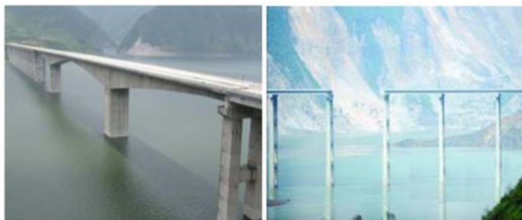
а) повреждённые мосты на гибких опорах
