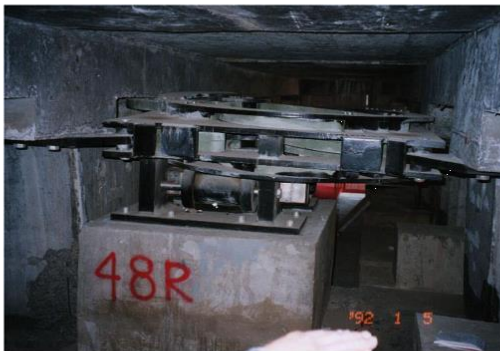
Рисунок 1.5 – Фотография поврежденных демпферов и вязкостных ограничителей
