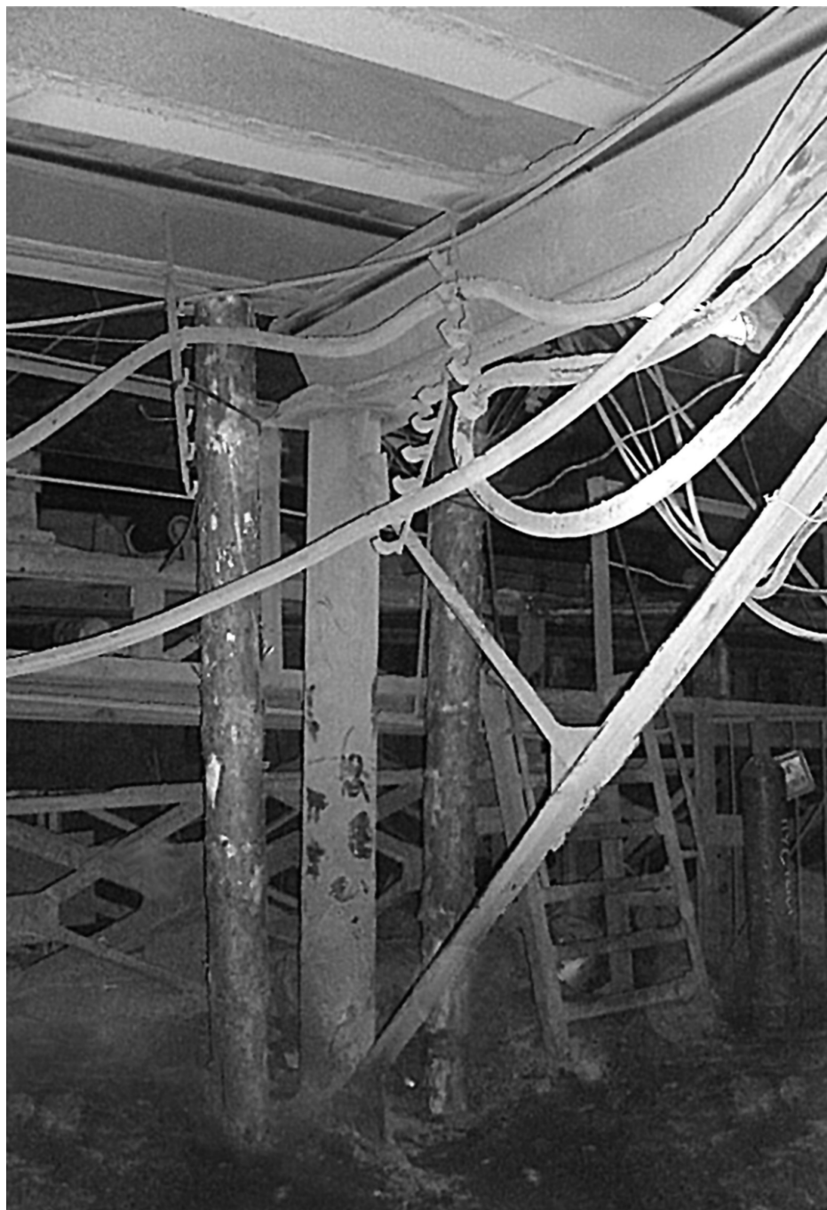
Рис. 2.7. Балки рамной крепи, подпертые дополнительно деревянными стойками в сопряжении капитальной выработки с площадью обнажения более 100 м 2 (камера приводов главного северного конвейерного штрека № 1 «Север» рудника БКПРУ-2).
