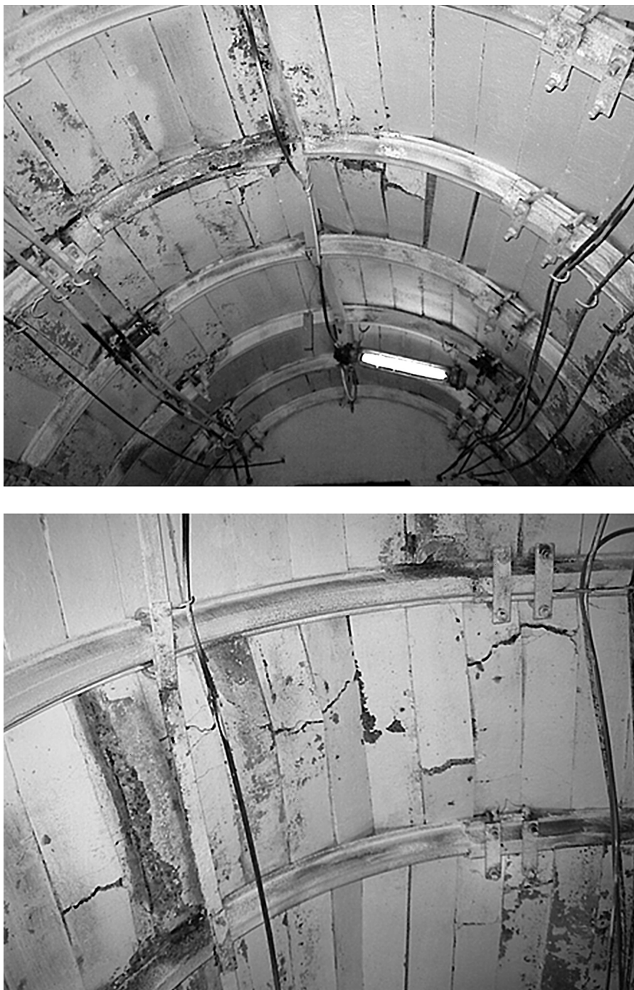
Рис. 2.13. Состояние крепи камеры ожидания клетового ствола на горизонте № 6 рудника «Интернациональный».
