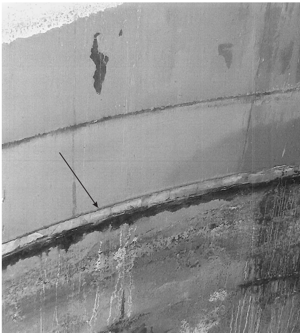
Рис. 6.46. Деформационный шов ствола № 2 Усть-Яйвинского рудника. Фото В.В. Тарасова.
