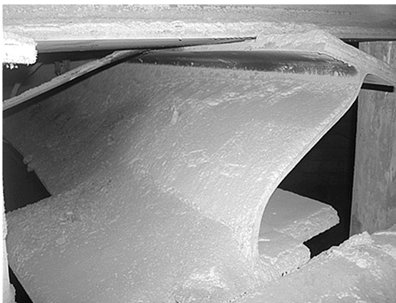
Рис. 2.6. Деформированная двутавровая балка № 40 рамной крепи сопряжения капитальной выработки с площадью обнажения более 100 м 2 (камера приводов главного северного конвейерного штрека № 1 «Север» рудника БКПРУ-2).
