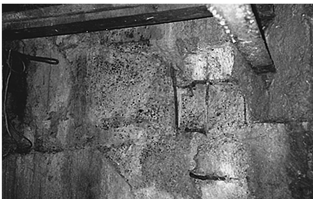
Рис. 2.17. Каверны в железобетонной крепи, образованные в результате сжатия дозаторной камеры и выпирания арматуры.
