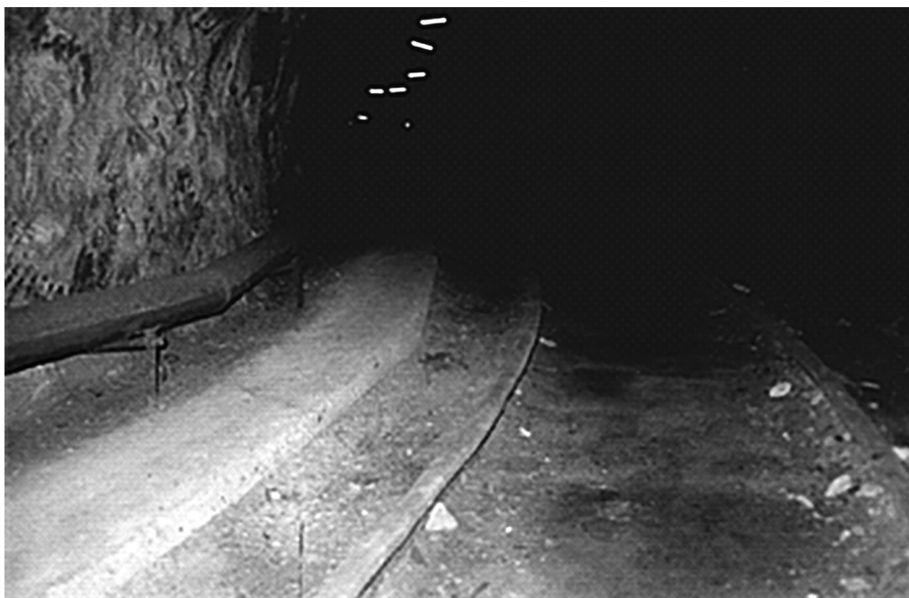
Рис. 2.14. Объездная околоствольная выработка скипового ствола на горизонте № 6. Видно проявление горного давления в форме пучения почвы (тротуарная плита приобрела боковой уклон около 6–8°).
