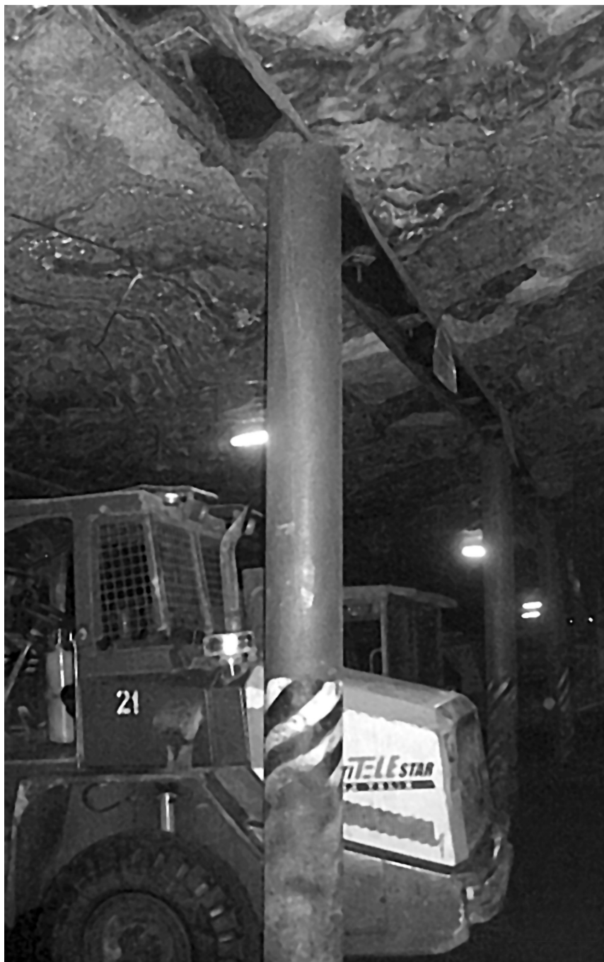
Рис. 2.9. Деформированный швеллер, выполняющий роль верхняка крепи и заколообразование в кровле комплекса большого количества сообщающихся капитальных выработок (автомобильный гараж рудника БКПРУ-2).
