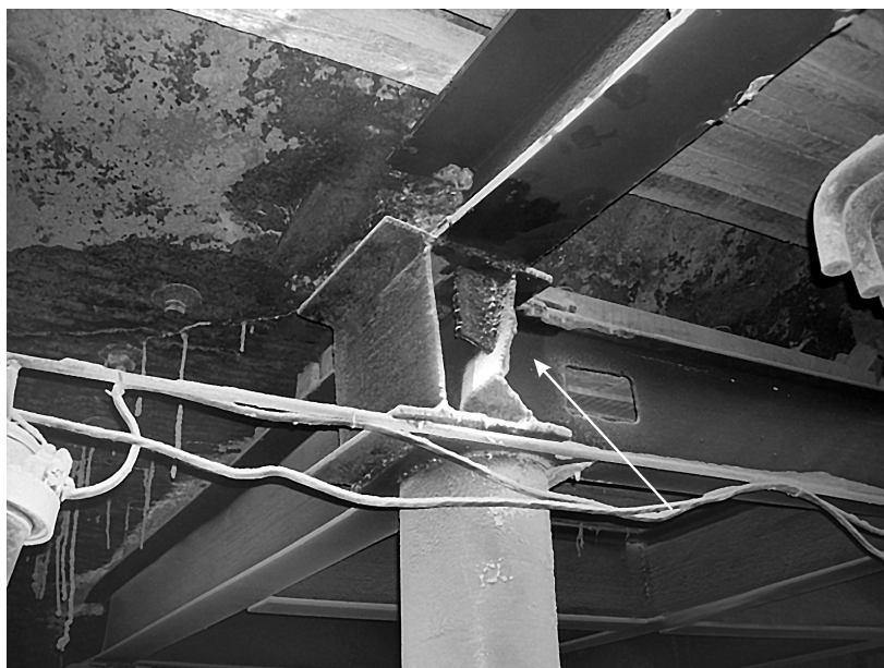
Рис. 2.5. Опираие пород кровли непосредственно на крепь (стрелкой показан изгиб косынки) в сопряжении капитальной выработки с площадью обнажения более 100 м 2 (камера дозаторной установки ствола № 5 рудника СКРУ-2).
