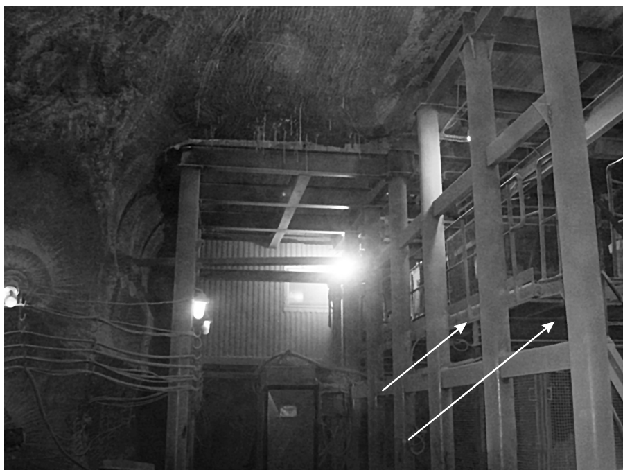
Рис. 9.8. Изгиб опорных труб-стоек дозаторной установки (показано стрелками).
