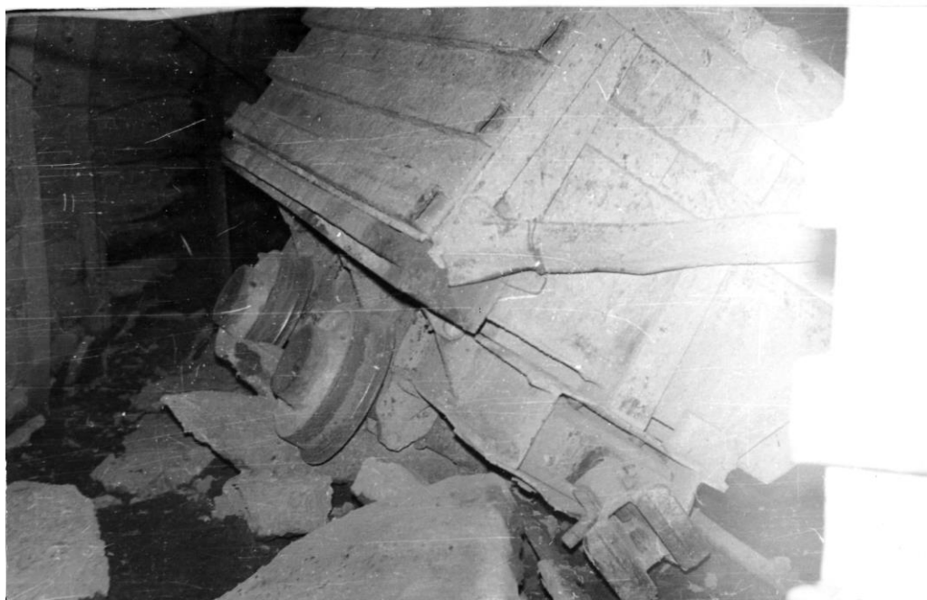
Рис. 16.6. Разрушение бетона в почве кольцевого штрека между ортами 16 и 17 горизонта -140 м.
