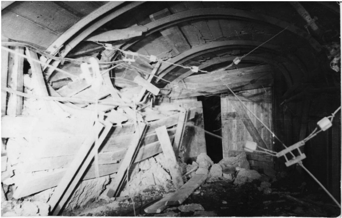
Рис. 16.7. Разрушение крепи из спецпрофиля в борту орта 18.
