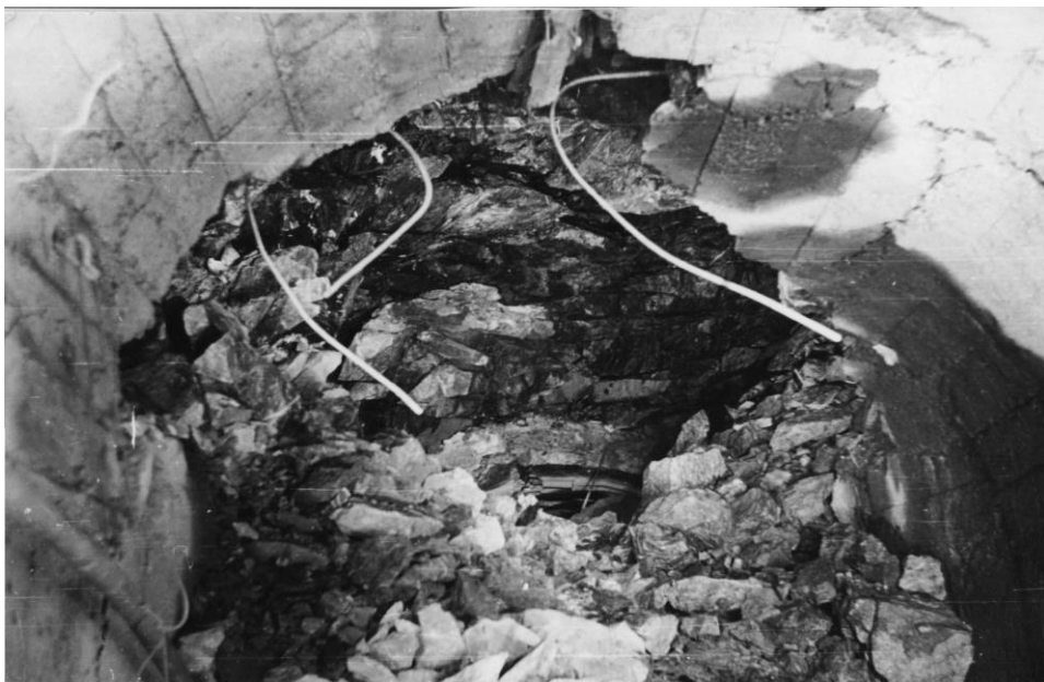
Рис. 16.12. Обрушение бетонной крепи в орте 18.
