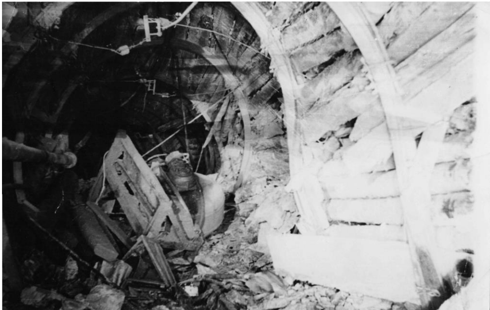
Рис. 16.13. Повреждение крепи и оборудования в орте 19.
