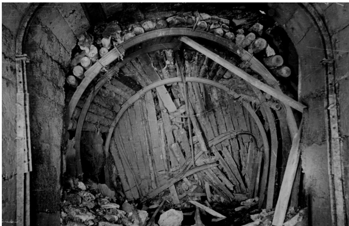
Рис. 16.10. Обрушение временной крепи в орте 16, горизонт -210 м.
