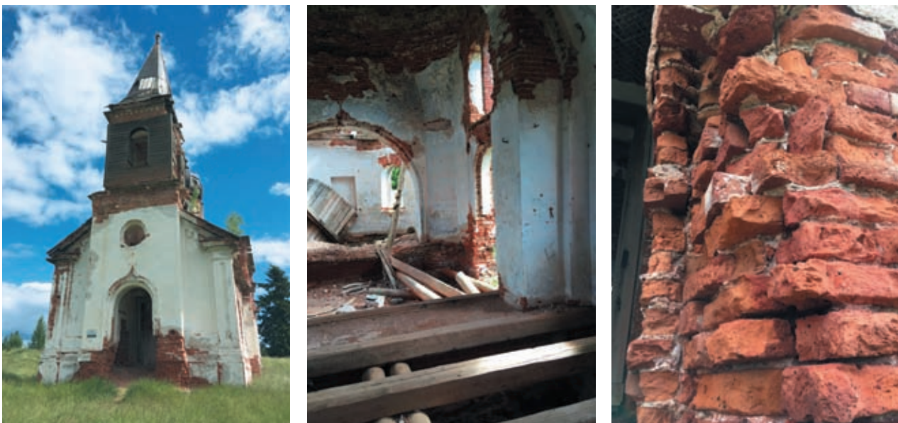
Рис. 9. Церковь Казанской Божьей Матери, внутреннее помещение и состояние стен (сентябрь 2020 г.)
