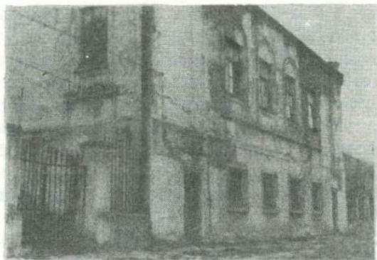
Рис. 6. Сдвиг бутовых стен 2-го этажа на уровне перемычек в ГПП-1
