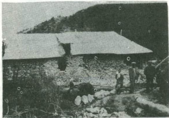
Рис. 6. Расслоение и обвал части стены из бутовой кладки
