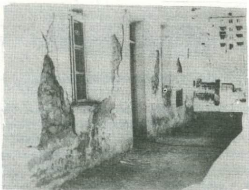
Рис.12. Повреждения в продольных (самонесущих) стенах из бутовой кладки молочного завода
