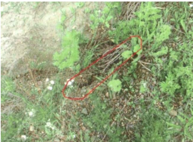
Рис. 24. Оползневая трещина (А.В. Леонова, 2011)
