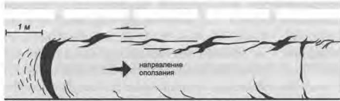
Рис. 2.13. Трещины отрыва и структуры типа pull-apart , возникшие в асфальтовом покрытии дороги в результате его отслоения и соскальзывания под действием гравитационных сил [Roberts, 2000].
