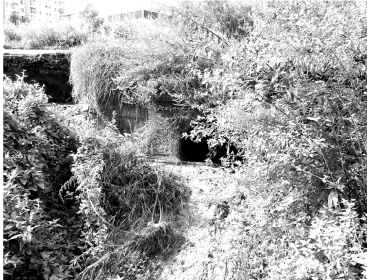
Рис 2. Размыв в вершине Верхнетатаровского оврага с подмывом велотрассы.
